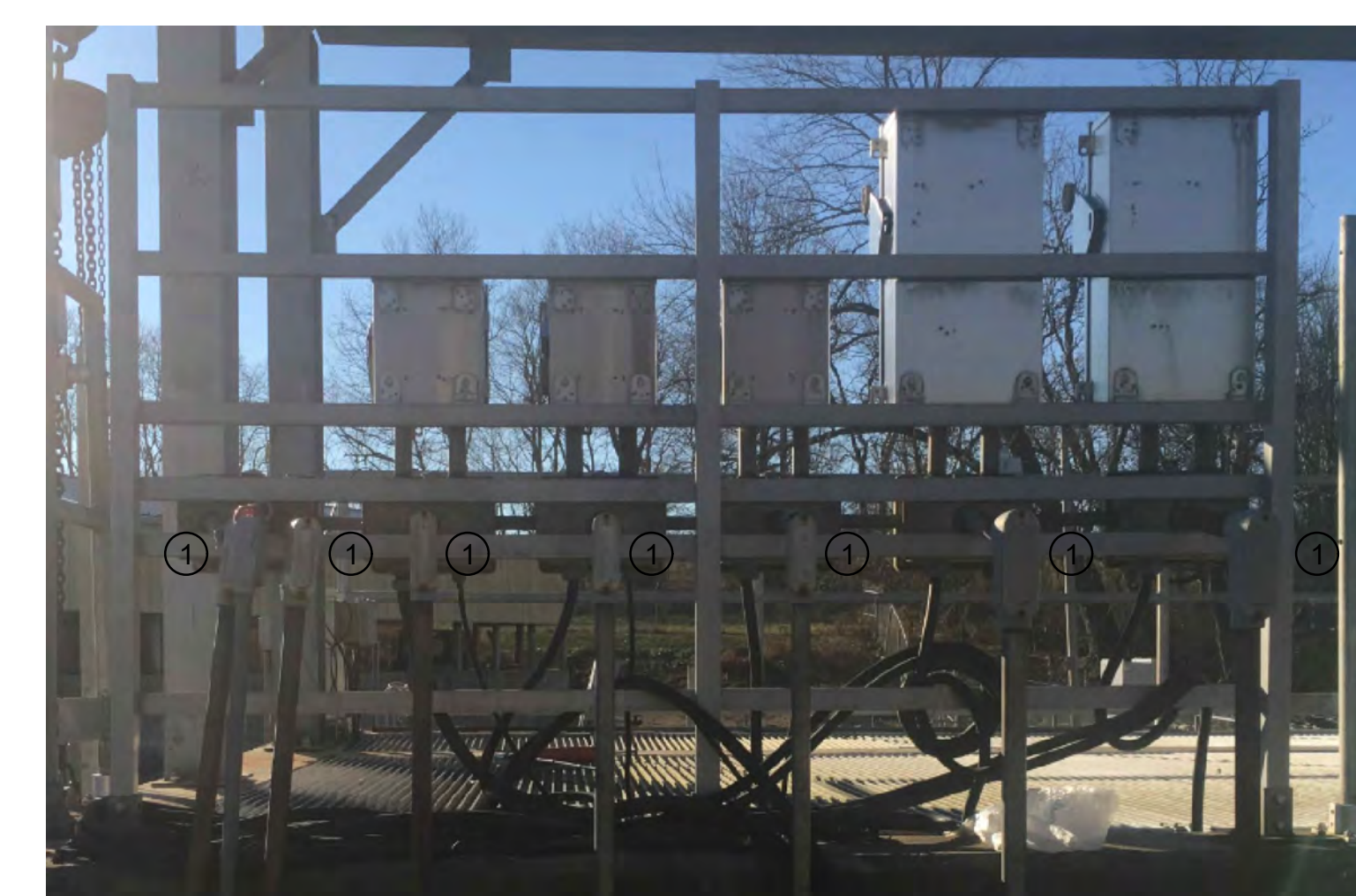
EXISTING RAW SEWAGE PUMP DISTRIBUTION CONDUITS
